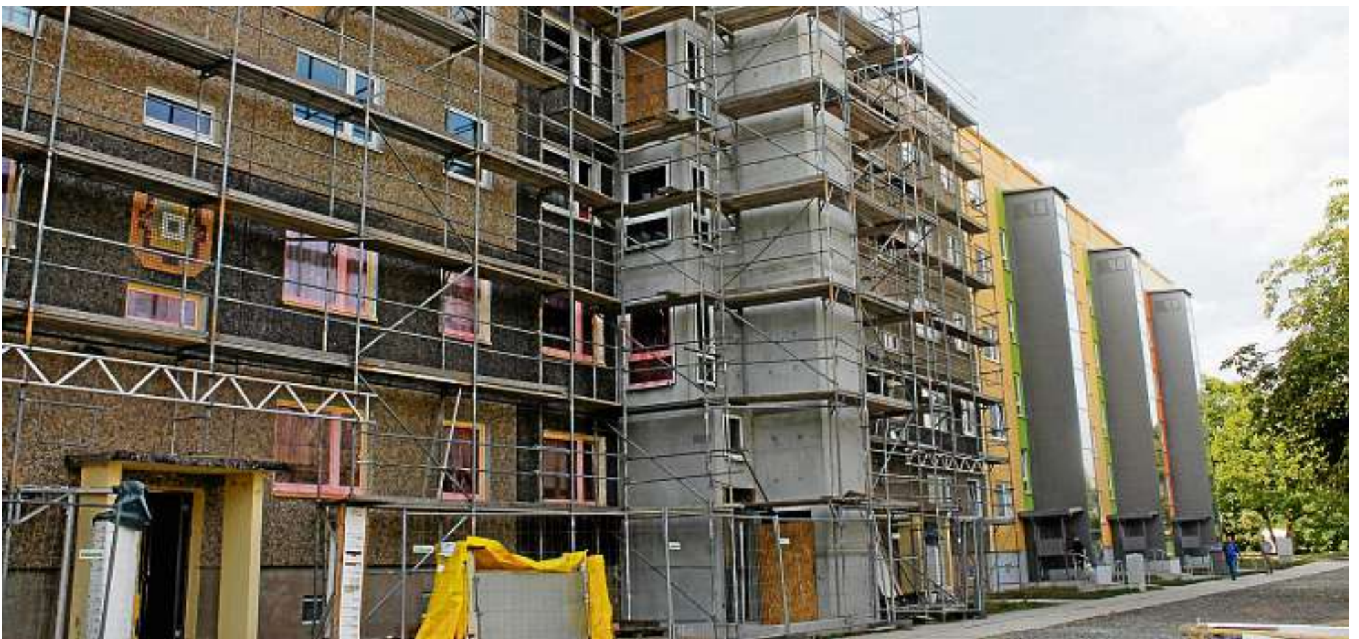
Häuser der WBG „Glück auf“ in der Rudolstädter Straße erhalten Laubengänge, Premiere für Gera
